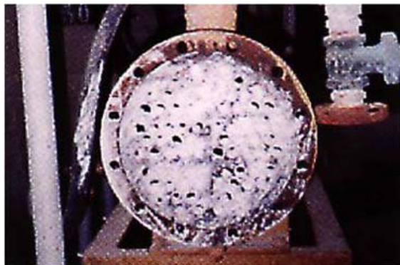
Röhren-Wärmetauscher vor Einsatz eines Hydroflow C 120 Kalkschutzgerätes.
